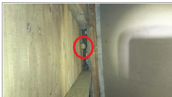
Abbildung 18: Während der Begehung der Dachböden wurde eine Vielzahl von Wespennestern festgestellt.
